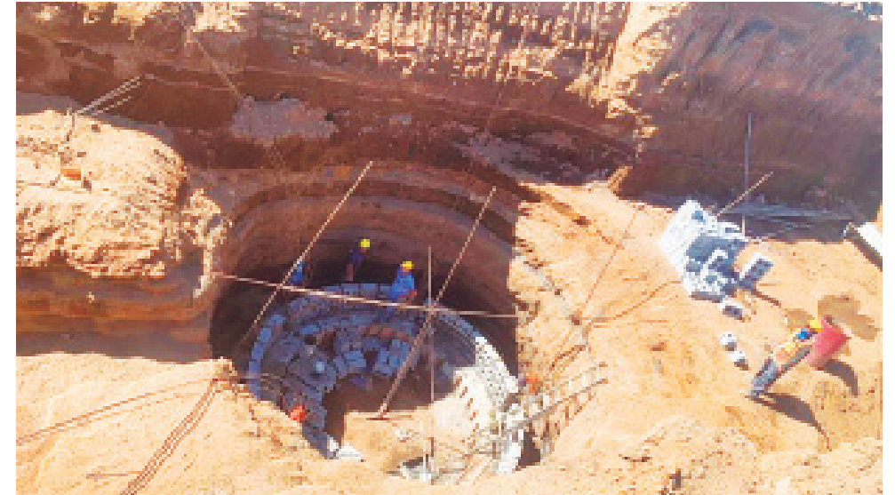
Se puede observar los trabajos de pega de mampostería en uno de los pozos de infiltración del sistema pluvial.
