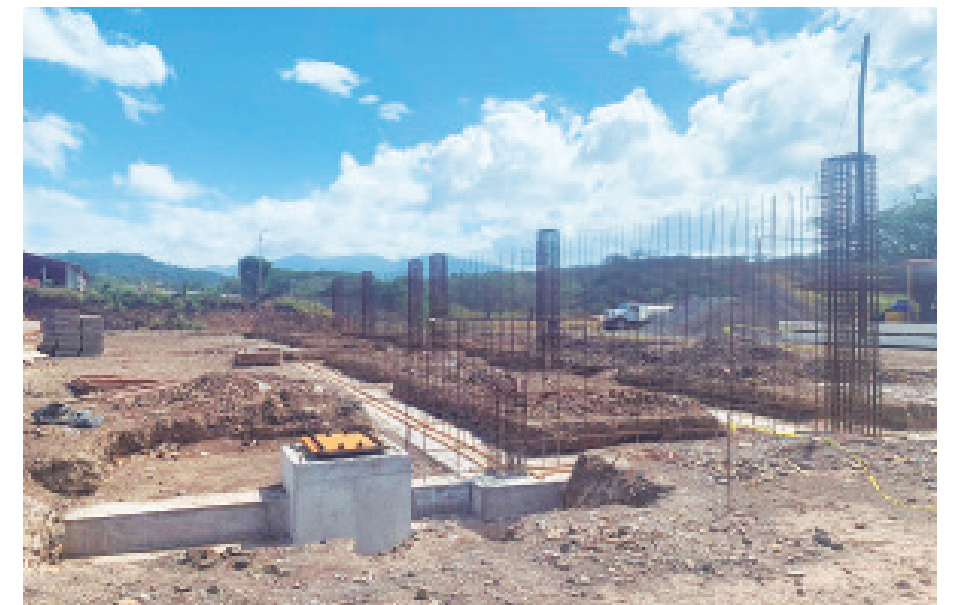
Se observa las fundaciones terminadas y la colocación del acero de refuerzo ya instalado de los muros del área de gradería del eje 5 al 6.
